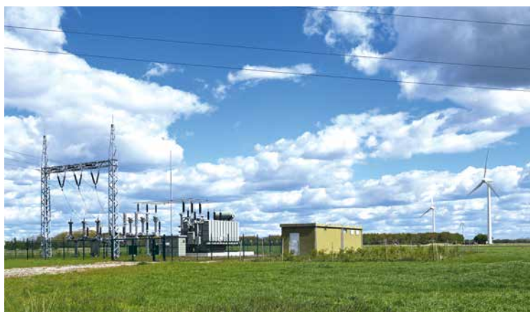
Ohne Umspannwerke könnte die nachhaltig erzeugte Energie von Wind- und Solarparks nicht in das Netz eingespeist werden
