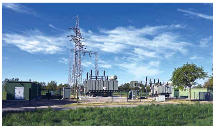
Die WT Energiesysteme GmbH hat bereits über 200 Umspannwerke realisiert
